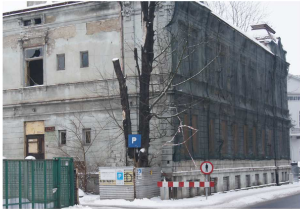
Ryc. 58. Przykłady stanów technicznych obiektów w obszarze rewitalizacji
