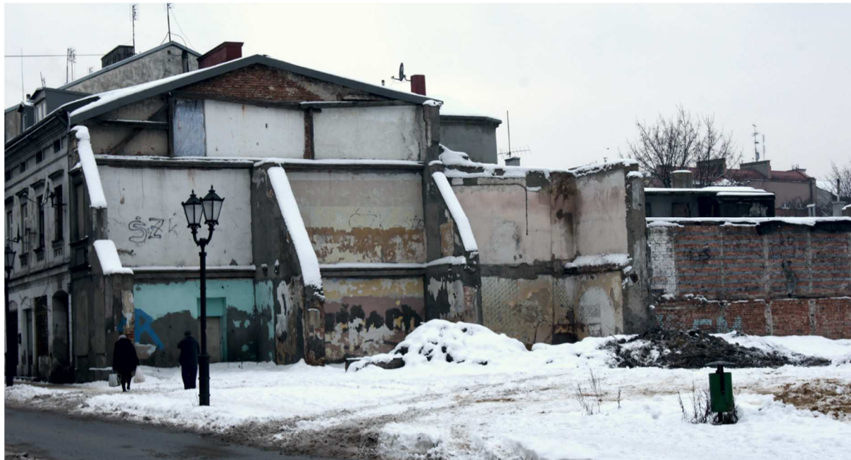
Ryc. 59. Stan techniczny zabudowy przy ul. Starowarszawskiej
